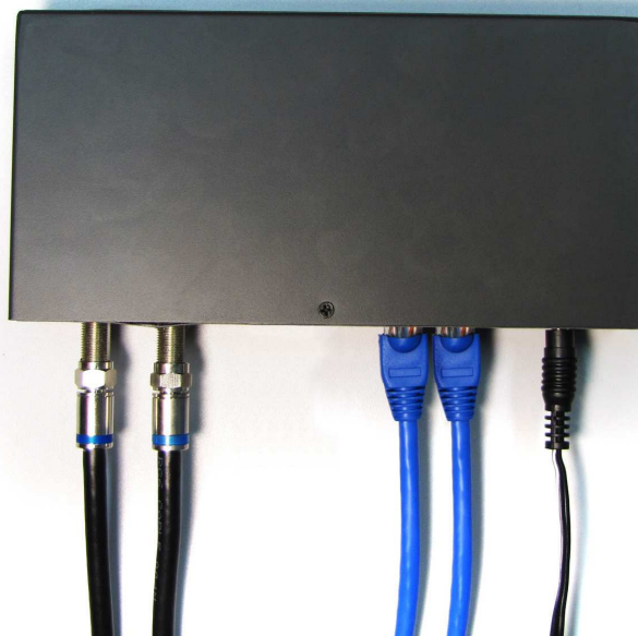
Figura 3.2-1: Conexão do cabo UTP e cabos coaxiais.
