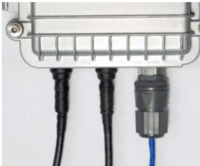
Figura 3.2-1: Conexão do cabo UTP e cabos coaxiais.
